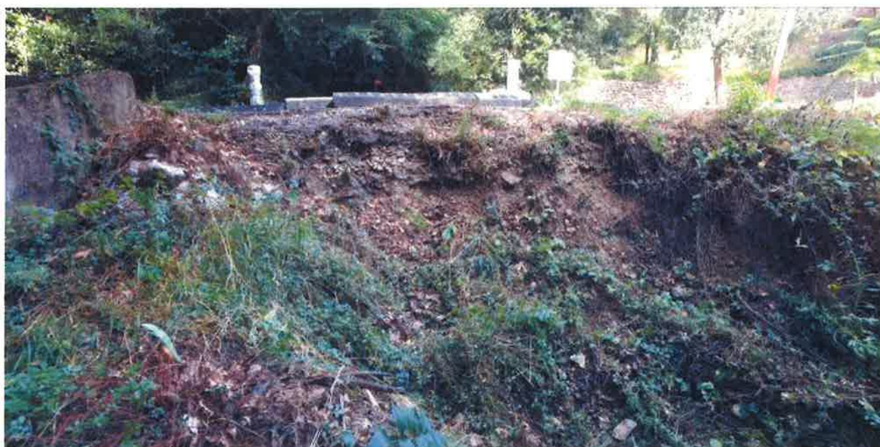
veine d'érosion Ouest
